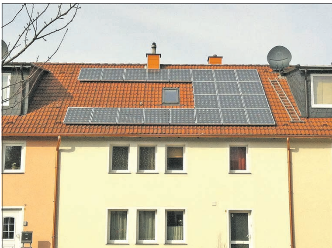
Mit Solarthermie spart man im Schnitt 60 Prozent Wärmeenergie.
