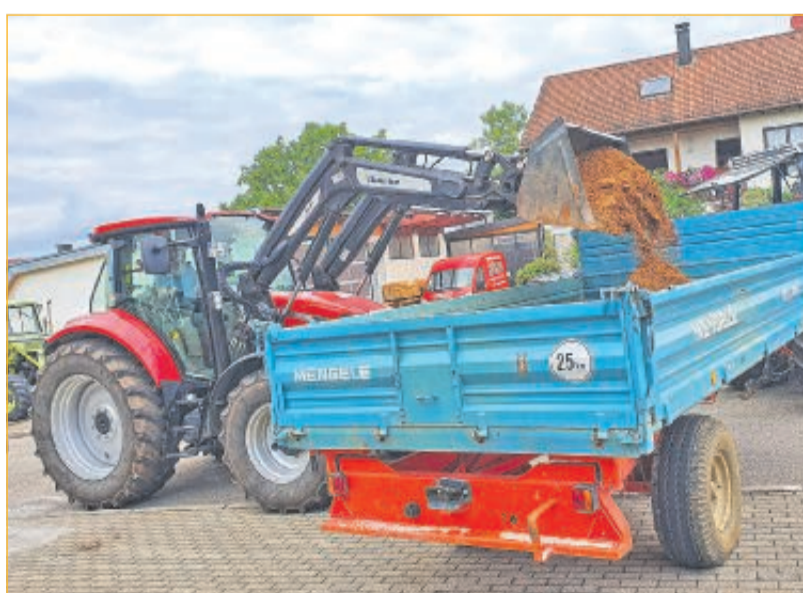
Bevor am Feuerwehrhaus ein Anbau errichtet werden konnte, musste erst einmal eine Menge Material in Form von Erdreich verladen und abtransportiert werden. Fotos: Gemeinde Waldstetten
